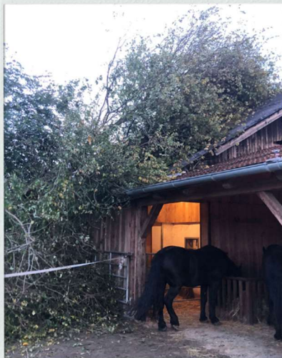
Baum auf Wirtschaftsgebäude 21.10.2023
